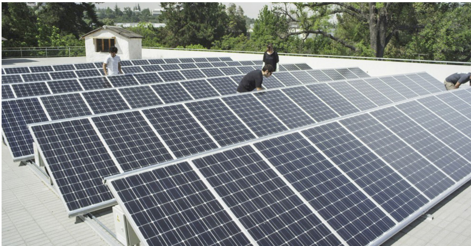
Figura 29: Sistema fotovoltaico edificio C1, campus Casona de Las Condes
